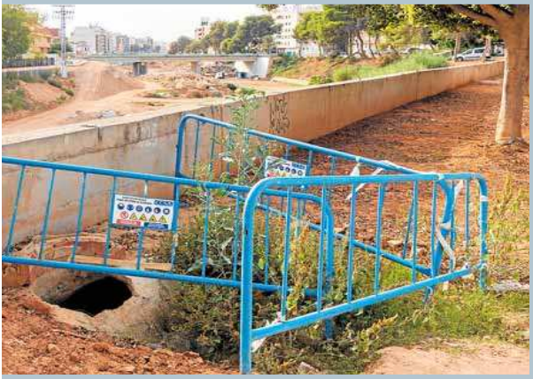
◀ Colapso. En Paiporta la totalidad de la red está afectada y algunos imbornales completamente colmatados de tierra.
